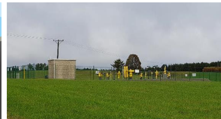
Przykładowa stacja zaworowa gazu
